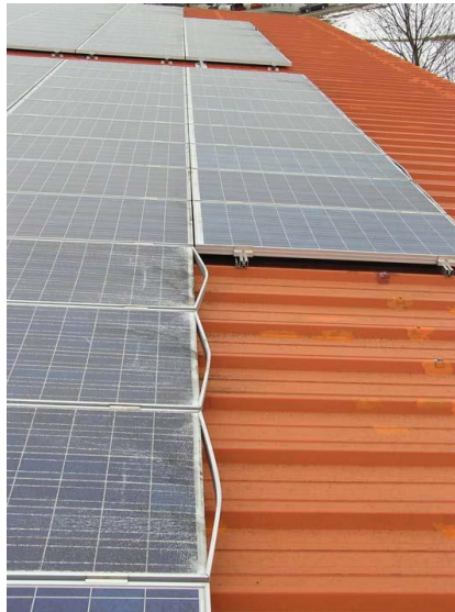
Σχήμα 1.8 Κατασκευαστικό πρόβλημα στο πλαίσιο [11]
