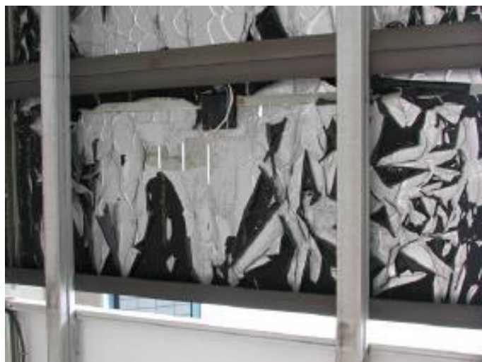
Σχήμα 1.4 Υπόστρωμα που έχει υποστεί εκτεταμένη αποκόλληση [8]
