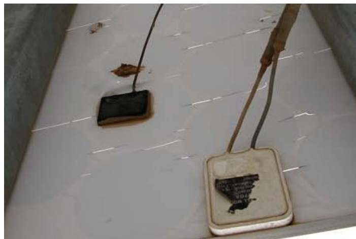
Σχήμα 1.3 Υπόστρωμα Φ/Β πλαισίου με εκτεταμένες ρωγμές [5]
