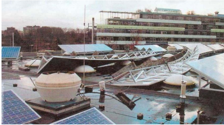
Σχήμα 1.7 Υποχώρηση πλαισίων στήριξης λόγω δυνατών ανέμων [12]
