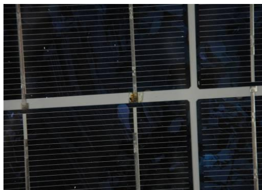
Σχήμα 1.44 Διάβρωση στις μεταλλικές διασυνδέσεις ενός πίνακα ηλιακών κυψελών [29]
