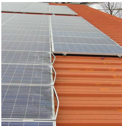
Σχήμα 3.4. Κατασκευαστικό πρόβλημα στο περιμετρικό πλαίσιο του Φ/Β πλαισίου [9].
