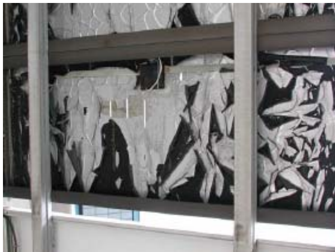
Σχήμα 3.3. Υπόστρωμα που έχει υποστεί εκτεταμένη αποκόλληση [6].
