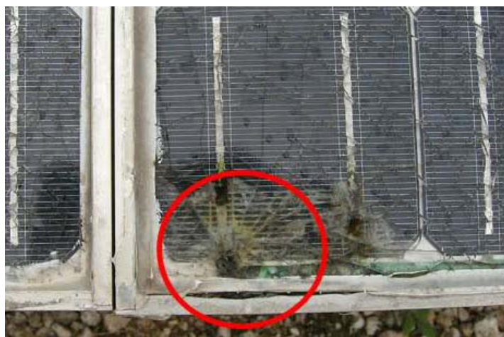
Σχήμα 3.1. Αστοχία λόγω θραύσης του εμπρόσθιου στρώματος ενός Φ/Β πλαισίου [4].
